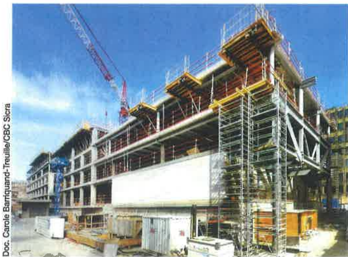
La façade (est) de l'extension présente une charpente métallique constituée d'un porte-à-faux de 4 m de portée, repris à chaque étage.
